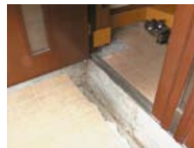
玄関部分の被害 断熱材撤去後の蟻道痕と家屋への侵入被害状況
