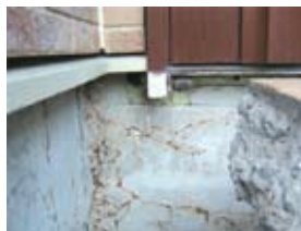
玄関の被害、断熱材撤去後の蟻道痕
