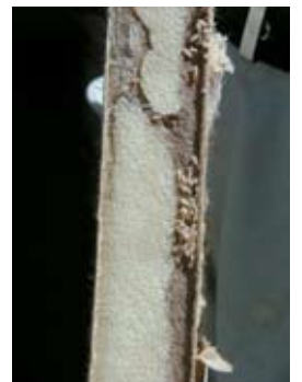
防蟻性能のない基礎外断熱のシロアリ被害(ヤマトシロアリ)
